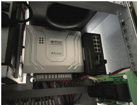
图 16 风电场工程实际现场图
